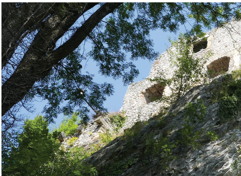
Slika 14: JZ del južne stene je danes povsem razvaljen, so pa vidne konzole nekdanjega kuhinjskega dimnika (levo na sliki).
