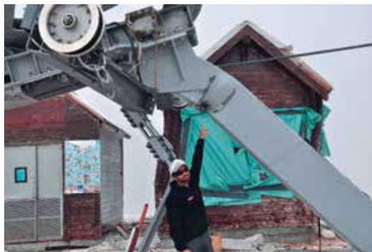
Slika 9: Od nakopičenega snega poškodovana žičniška konstrukcija na Prevali, avgusta 2014
