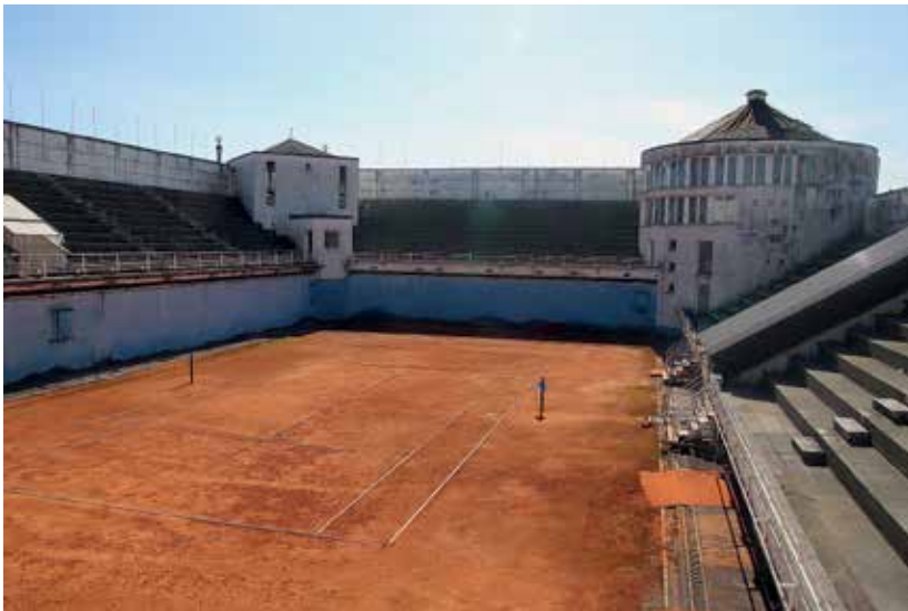
Slika 11: Notranje igrišče Športnega parka Domžale so pred časom ponovno očistili in uredili za uporabo, na tribunah in objektih pa so vidni znaki propadanja, čeprav je bil objekt zgrajen leta 1989.
