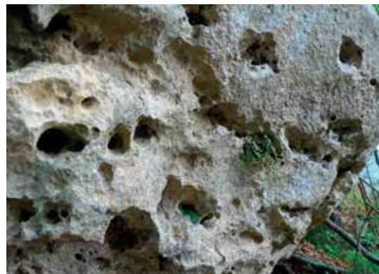
Slika 14: Korozijske razjede v čistem apnenecu kot primer kemičnega preperevanja.
